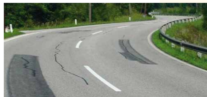
➤ Gravierende Fahrbelagmängel: Griffigkeitswechsel, Spurrillen und „Flickenteppiche“ auf der Fahrbahn
