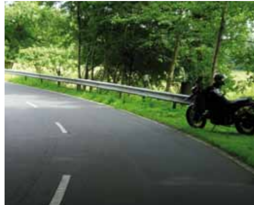
➤ Kurvige Fahrbahn ohne Unterfahrschutz
