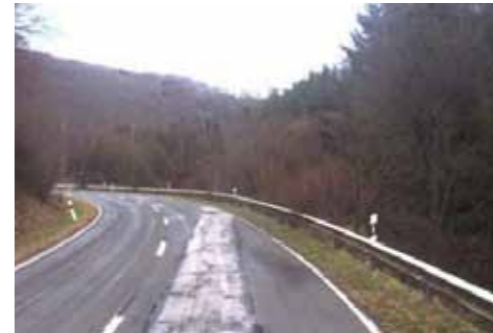
➤ Derartige Straßenschäden können für Motorradfahrer verheerende Folgen haben
