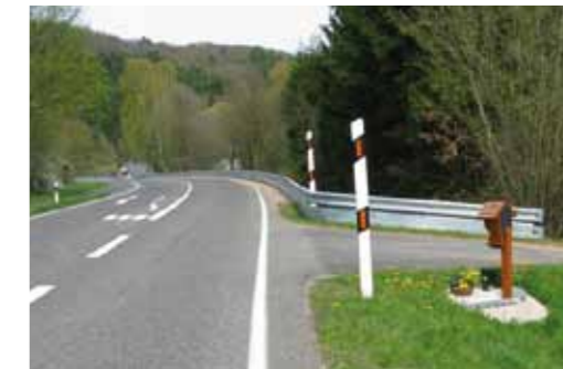
> Nachher: Anlegen einer Aufstellmöglichkeit für Linksabbieger; Erkennbarkeit der Zufahrt durch überhohe Leitpfosten verbessert
