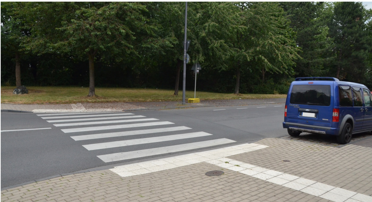
Mangelnde Sicht durch falsche Anordnung von Parkständen am Zebrastreifen eines Kreisverkehrs, fehlende differenzierte Bordhöhen und fehlender Fahrbahnteiler (Mittelinsel)
