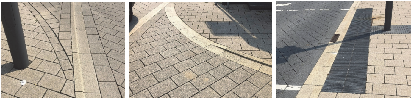
Bilder 36 bis 38 | Oberflächenmaterialien im zentralen Bereich: durchgängig in Fahrbahn, Nebenstraßeneinmündungen und Seitenräumen verlegtes Betonsteinpflaster in hellem Weißbeigeton (links), niedriger Sonderbordstein mit Reduzierung auf Null im Zuge des Gehwegs (Mitte), anthrazitfarbene Fahrbahnplasterung sowie Noppen- und Rillenplatten zur sicheren Führung von Blinden, Sehbeeinträchtigten und Benutzer*innen von Gehhilfen, Rollatoren und Rollstühlen (rechts)
