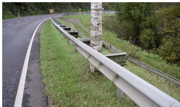
Bild 4: Falsche Anordnung der Schutzeinrichtung bei einem Baum
